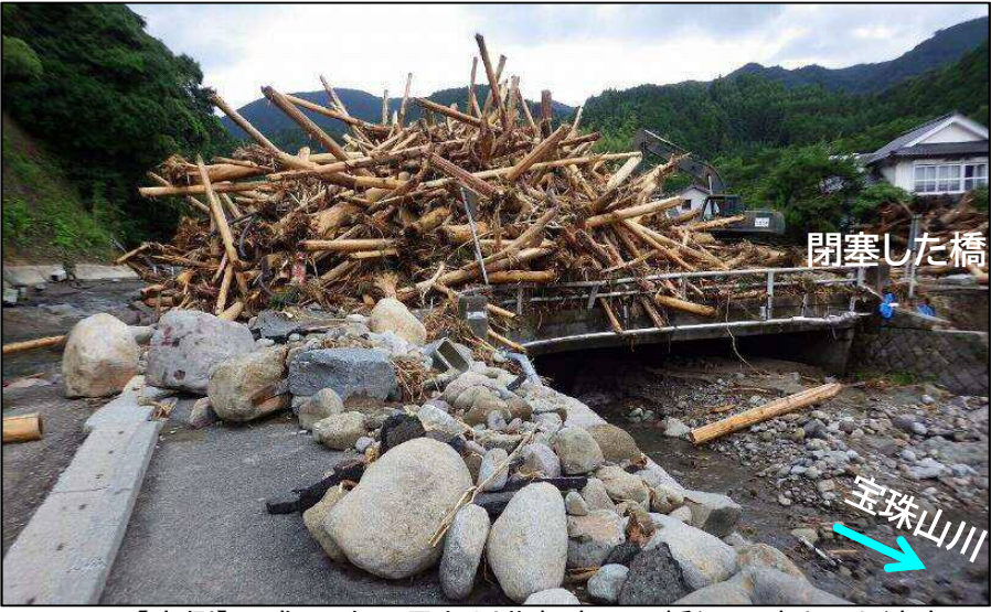
【事例】平成29年7月九州北部豪雨で橋梁に詰まった流木 (撮影場所:福岡県東峰村宝珠山川)
