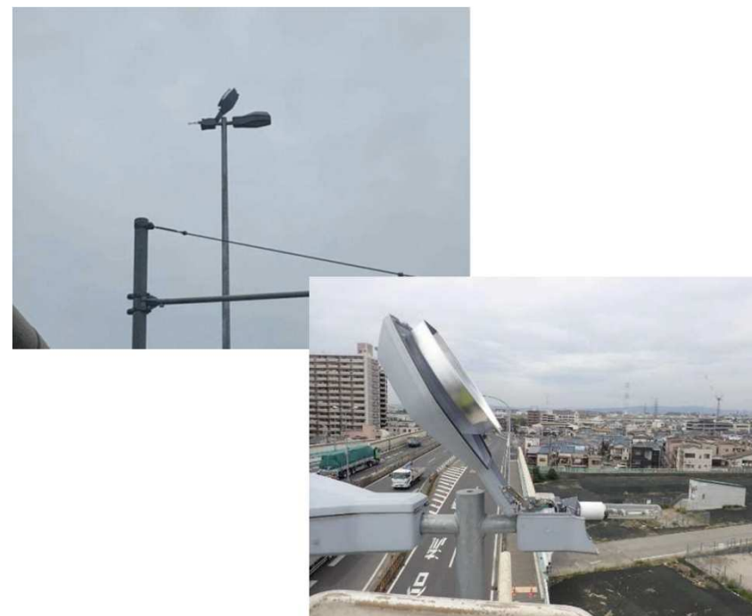
図 国道25号における照明灯具破損・落下事故 (左:発見時の状況、右:破損状況)
