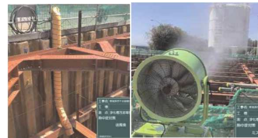
送風機により通気性を確保するとともに、ドライミスト発生装置等も併用
