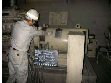
〈発電設備 定期点検状況〉
