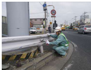
〈構造物の状況確認（防護柵損傷）〉
