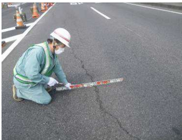
〈路面状況確認（わだち発生）〉
