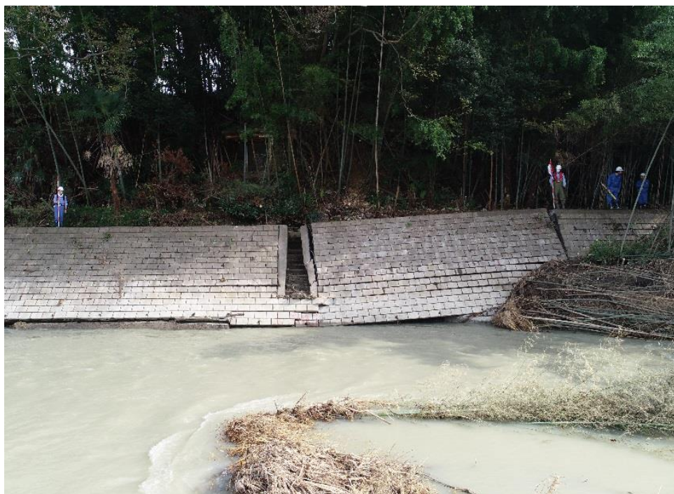
②①多摩川 55. 6k 左岸（東京都羽村市） 護岸崩壊 L=42m
