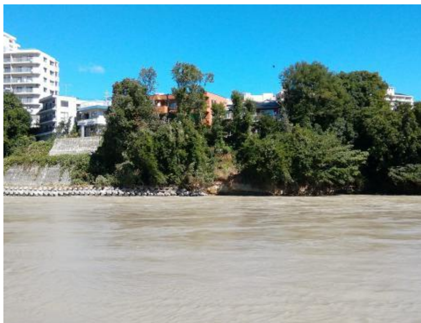
②②多摩川 58. 2k 左岸（東京都青梅市） 根固ブロック流出 L=18m
