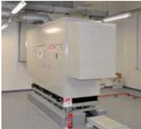
非常用発電設備のイメージ
