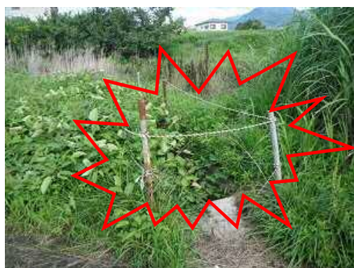
ロープの一部が切れている
