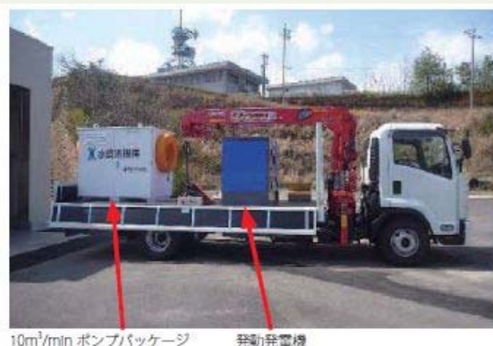
10m 3 /min ポンプパッケージ 発電発電機
