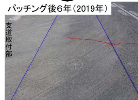
写真-2 路面状況（1箇所の経年変化）
