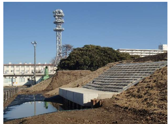
写真-2 偏流に起因する護岸基礎の侵食
