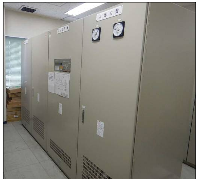
無停電電源装置(水管理棟)
