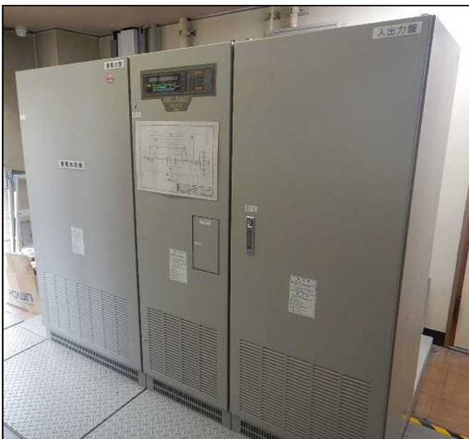
無停電電源装置(事務所庁舎)
