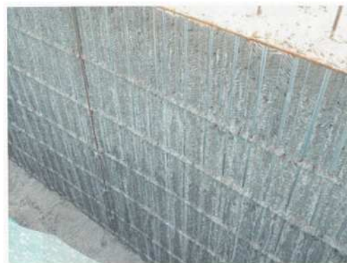
図-5 ラス型枠採用時のコンクリート表面
