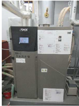
図-3 木質ペレットボイラー
