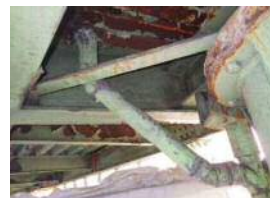
写真-11 腐食した鋼管
