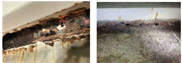
写真-7 端部の腐食
