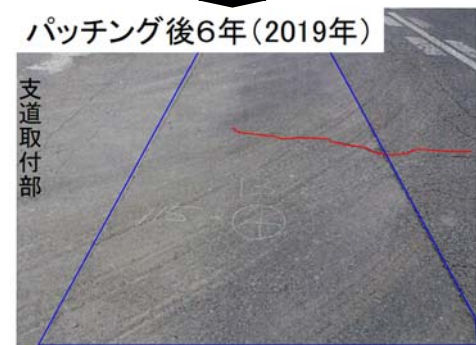
写真-2 路面状況（1箇所の経年変化）
