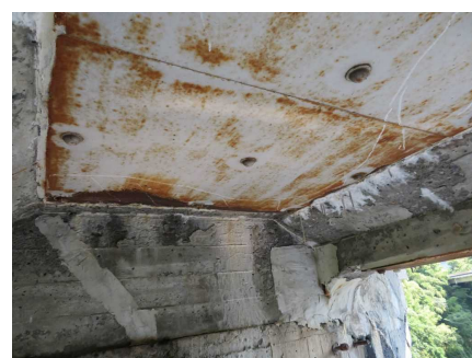
写真-2 定期点検の結果（補強鋼板の損傷）
