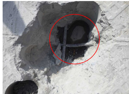
写真-6 補強鋼板裏面の滞水状況
