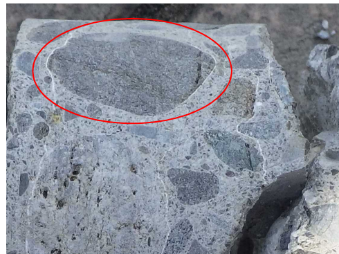
写真-7 骨材の周辺の白色析出物
