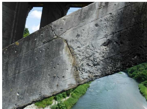
写真-4 アーチリブのコールドジョイント
