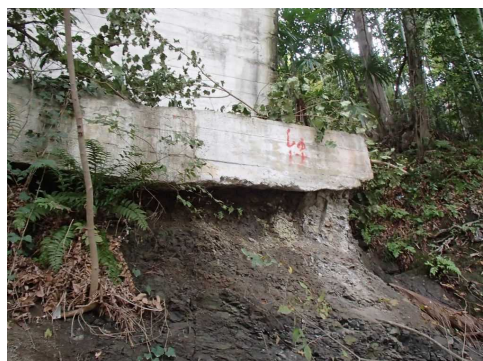
写真-5 アーチアバットの浸食の状況
