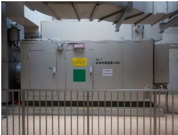
写真-4 庄和排水機場自家発電設備
