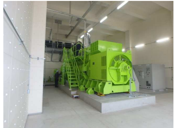
写真-3 新設自家発電設備
