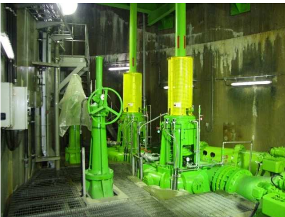
写真-1 第3立坑1次残水排水ポンプ
