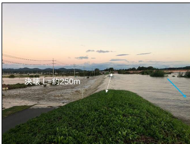
写真-1 堤防の越水状況（那珂川右岸28.6k）
