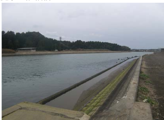
護岸の修繕前
