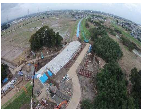
【都幾川堤防の災害復旧】 撮影者会社名・撮影者:伊田テクノス(株) 柿沼美行
