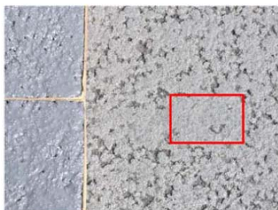
写真-5 現地舗装の遮熱材ダメ箇所
