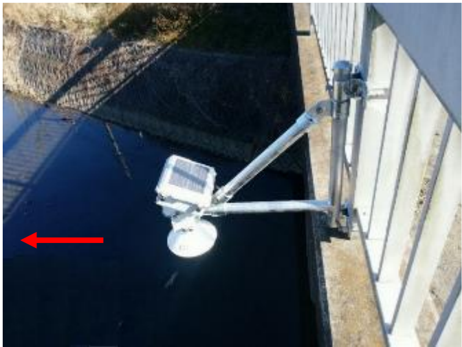
【小藪橋(鹿沼市)に設置した水位計(平成30年度)】
