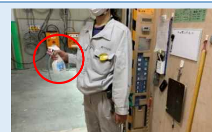
EVの操作盤等の消毒を徹底
