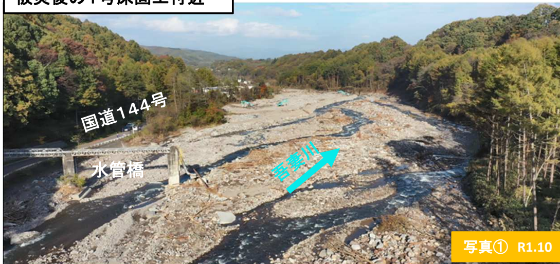
被災後の1号床固工付近
