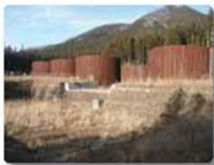
3 久次良地区 (野上沢下流防砂堰堤) 久次良地区(野上谷川下游防砂壩)
