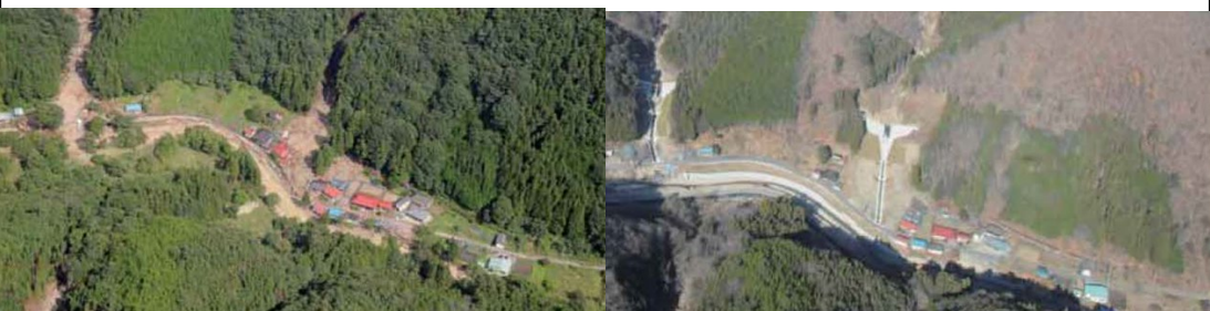
从直升机上确认到的受灾状况 在灾后进行防沙堰堤施工
