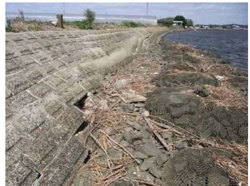
護岸ブロックの欠損
