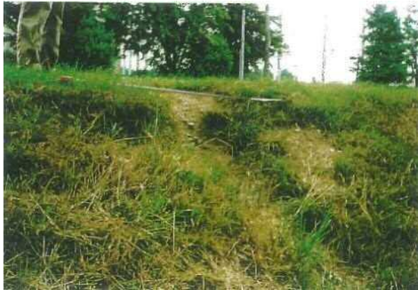
降雨による法面侵食
