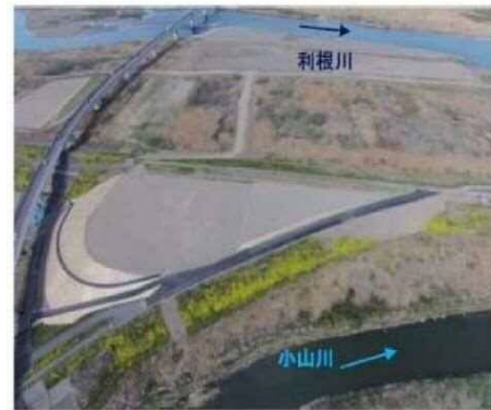
下高島地区(埼玉県深谷市)
