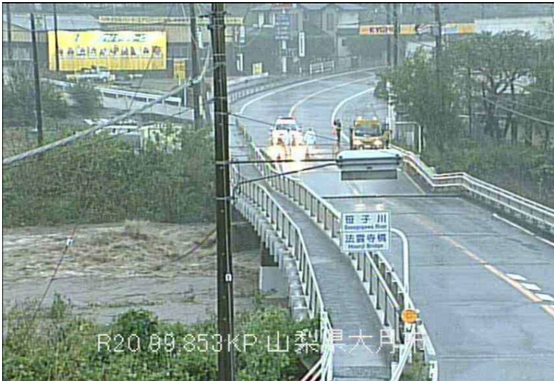
国道20号 法雲寺橋の一部損壊の状況
