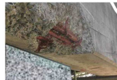
損傷状況(鉄筋露出)
