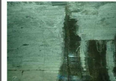
損傷状況(うき・漏水)
