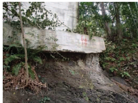
泥岩の浸食による底版の露出
