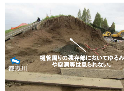
②樋管周りの残存部 （下流側断面 R1/10/15撮影）
