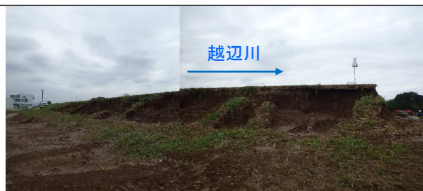
①越流水によると推定される川裏部の洗掘
