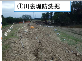
②川裏堤防洗掘
