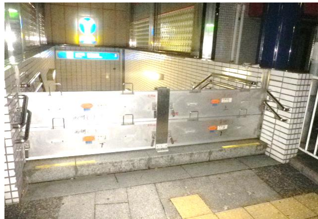
止水板(地下鉄入口の例)
