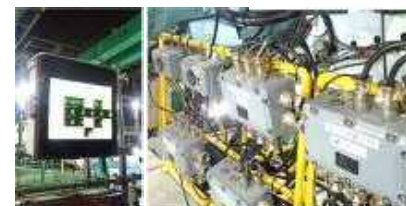
①ガス監視モニター(左)・ガス検知器システム(右)
