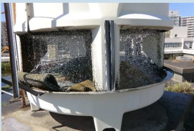
冷却塔のルーバー、マット破損
