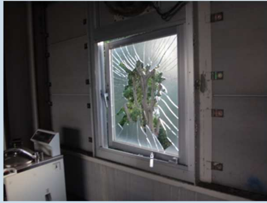
窓ガラスの破損
