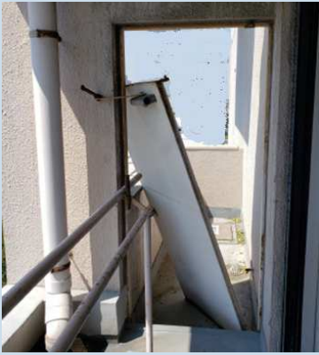
老朽化した扉の破損
