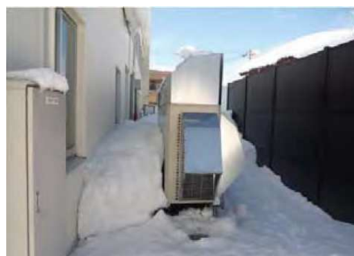
室外機の周りは除雪しましょう
