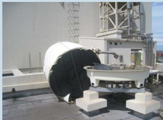
冷却塔の分断
