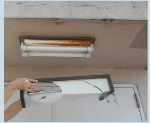
照明器具カバーの破損
