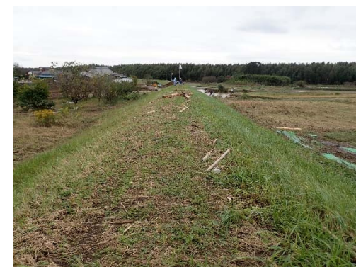
③天端に越水による漂流物(流木)が残存 (R1/10/15撮影)
