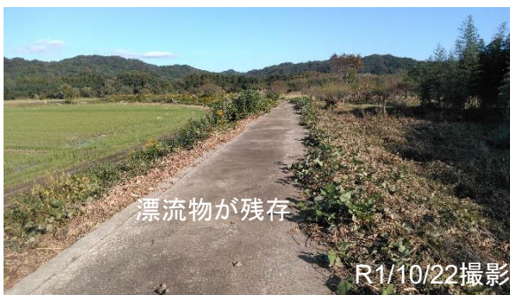
②天端～川裏側法肩に漂流物が残存している。
