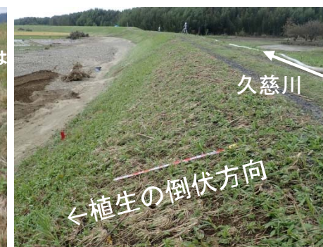
左岸27.0k(決壊箇所下流)
