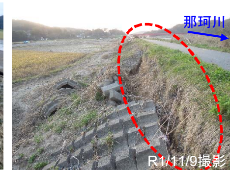
②川裏部が洗掘されている。
