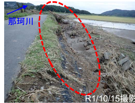
①川裏部が洗掘されている。
