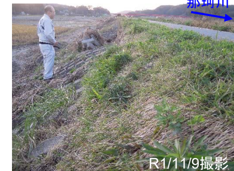
④川裏部の植生は川裏側に倒伏している。
