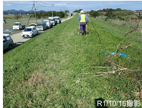
①天端に漂流物が残存している。
