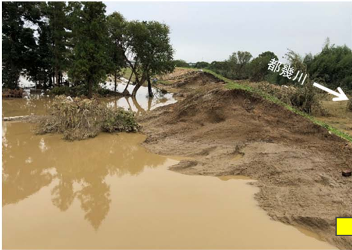
2019.10.14 12時00分時点 被災状況
