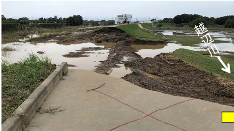
2019.10.14 9時20分時点 被災状況
