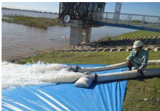
東宝山第1樋管 令和元年(10月14日(月)6時頃
