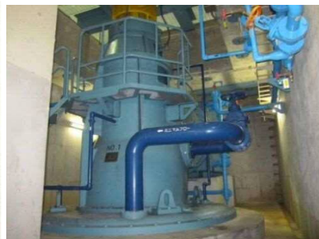
排水機場のポンプ
