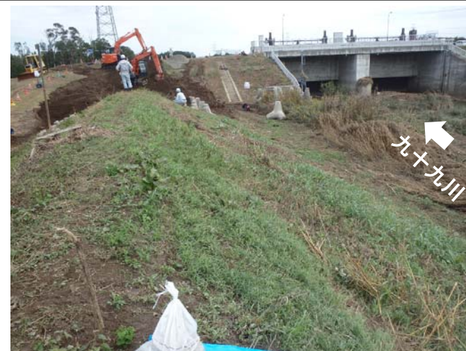
①堤防川表法面状況(決壊区間上流より、R1/10/16撮影)
