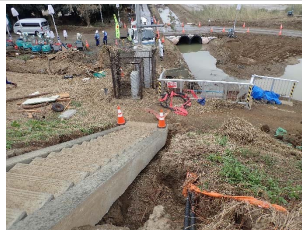
②越水に伴うと考えられる階段周りの侵食 (決壊区間上流より、R1/10/17撮影)
