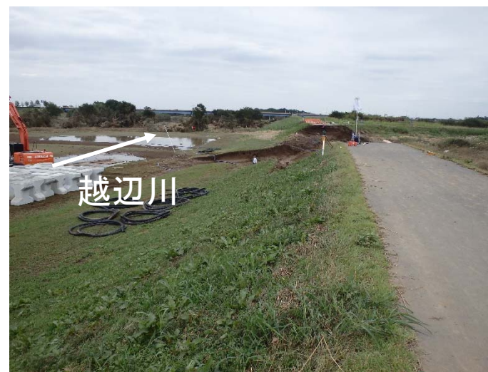
①堤防川表法面状況(決壊区間上流より)(R1/10/16撮影)
