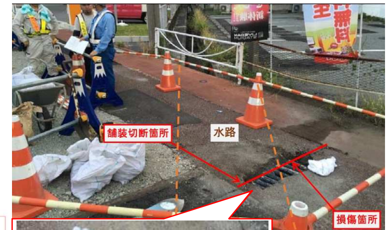
事故発生状況
