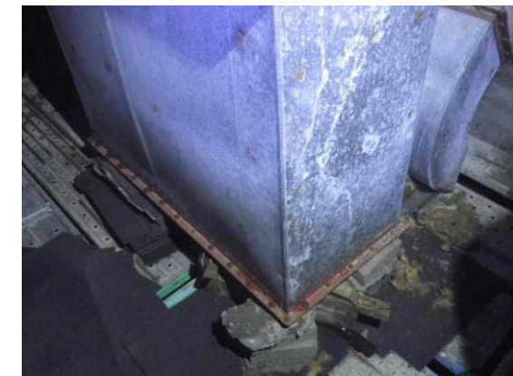
落下した縦ダクト
