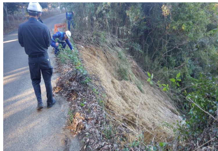
茂原市内の被災箇所現地調査
