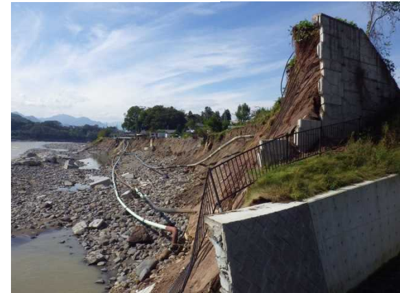
【②道路崩落】
