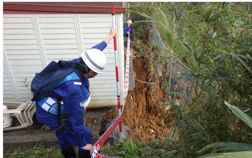
長柄町内の被災箇所現地調査
