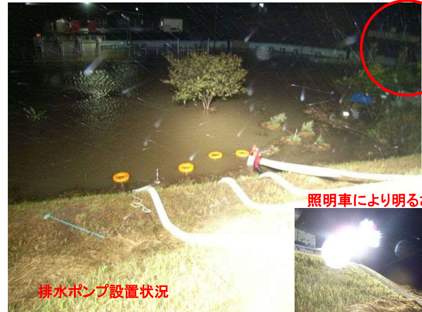
高田排水機場
