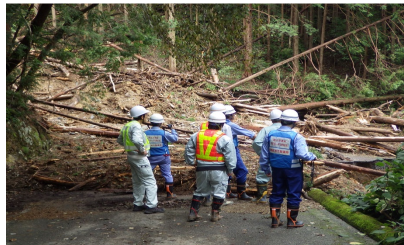
市道の被災状況調査(栃木県栃木市)
