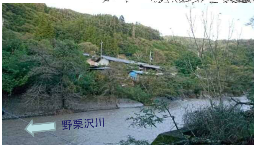
護岸の被災状況(R1.10.13)
