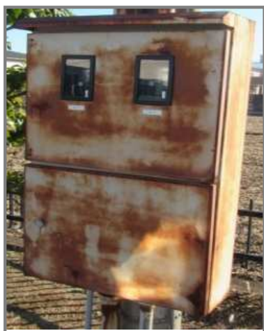
錆を落とし再塗装程度の補修で対応可
