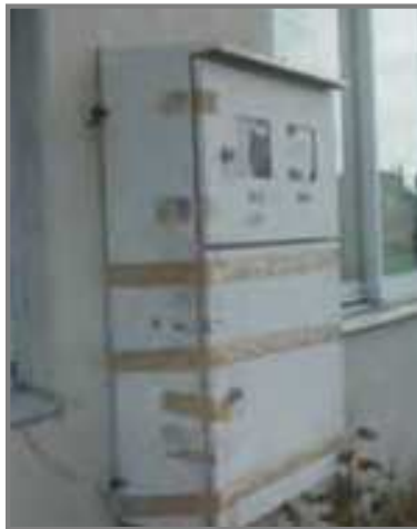
盤の施錠が出来ないため、ガムテープで固定している状態。盤の修繕が必要
