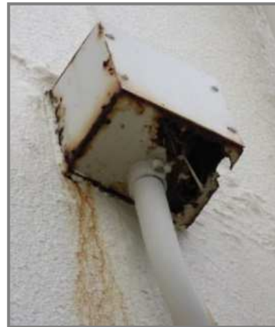
腐食がひどく、外板に穴が開いている状態。ボックスの交換が必要
