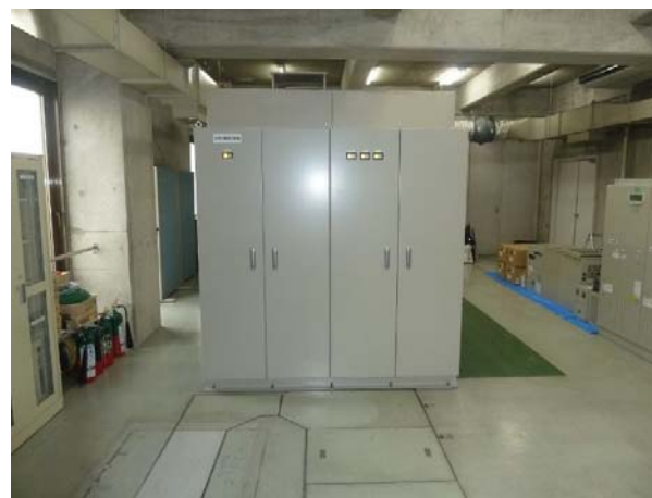
完成(非常用電源切替盤)
