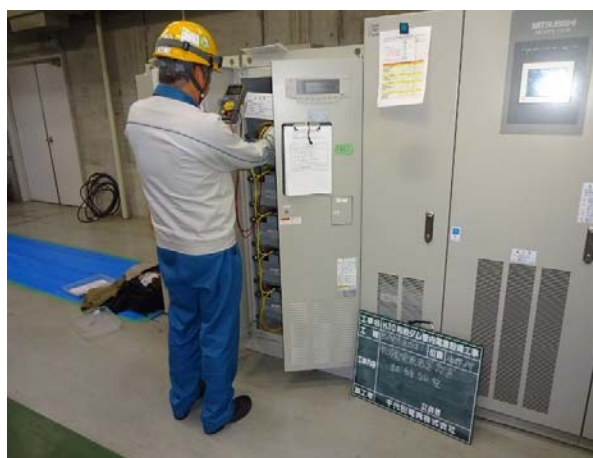
無停電電源装置調整状況
