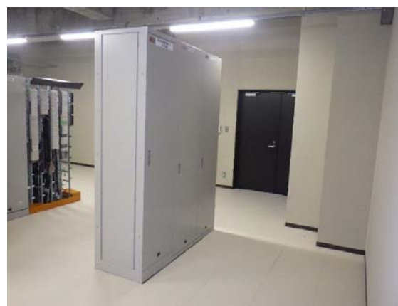
完成(電気室内)
