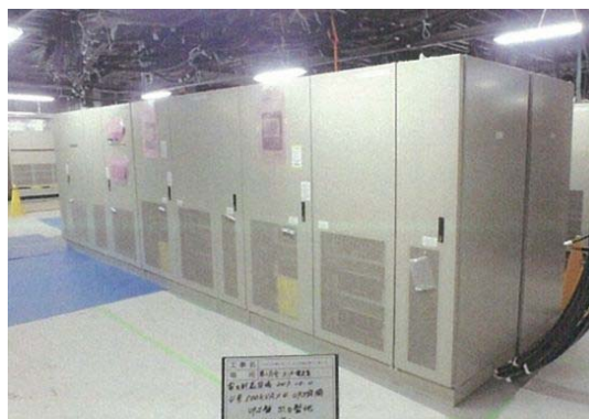
4号 UPS盤・出力盤
