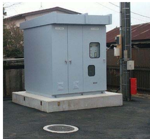
受変電設備施工後
