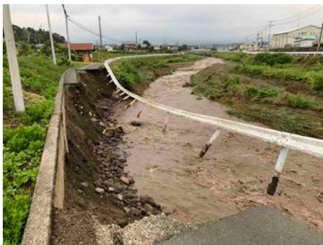
前橋市河原浜町 荒砥川右岸 法面、道路崩落
