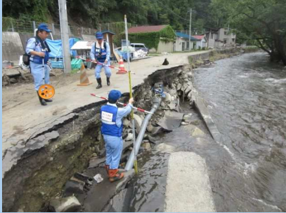
河川・道路の被災状況調査 (岩手県岩泉町)
