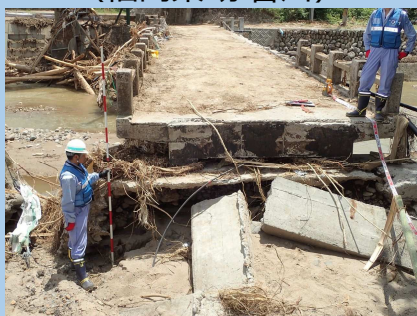
橋梁の被災状況調査
