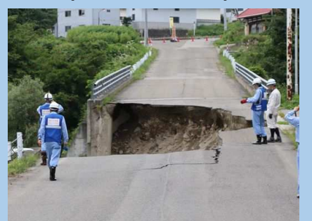
町道の被災状況調査 (福島県 南会津町)
