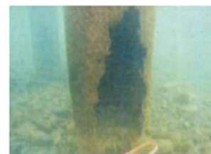
▲橋脚水中部の断面欠損
