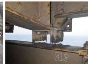
▲シェッド主梁端部破断
